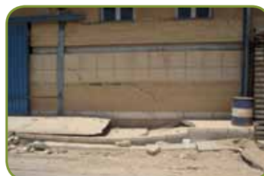
آسیب‌های به وجود آمده در اثر نشست‌های قابل توجه
